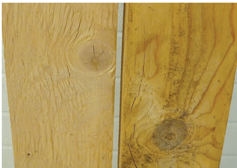
Рис. 1. Трещины в наружных слоях шпона LVL-бруса
